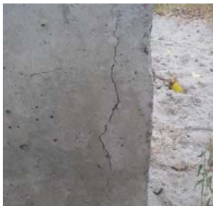
Рис. 1. Колонна, которая потеряла прочность от перегрузки и влияния внешних факторов
