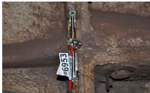
Рис. 5. Датчик системы мониторинга, установленный на чугунном тубинге
