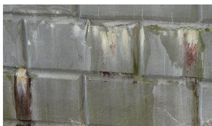
Рис. 2. Подтеки на низовом открылке правобережного устоя
