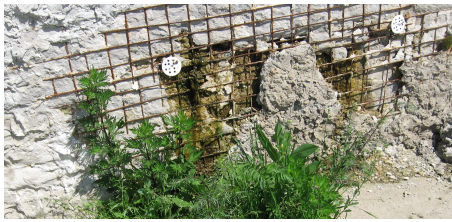
Рис. 3. Разрушение низового открылка левобережного устоя Тетеринской ГЭС
