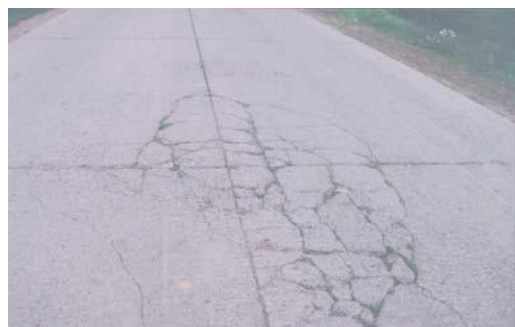
Фото 1. Трещины на дорожном цементобетонном покрытии
